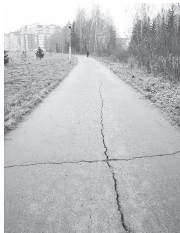
Глубокие трещины вдоль и поперёк тротуара...
