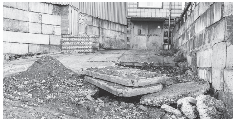
Негативные последствия работы нерадивых хозяйственников на ул. Сиреневой налицо
