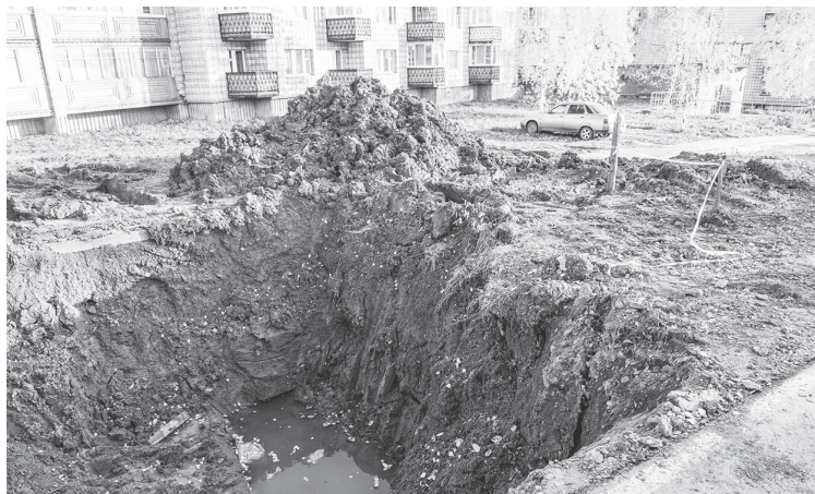
Нижняя Тура, ул. Гайдара. Такие рытвины явно не украшают город и являются источником опасности
