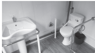
В таком виде использование туалетной комнаты инвалидов невозможно, г. Нижняя Тура, парк «Центральный»
