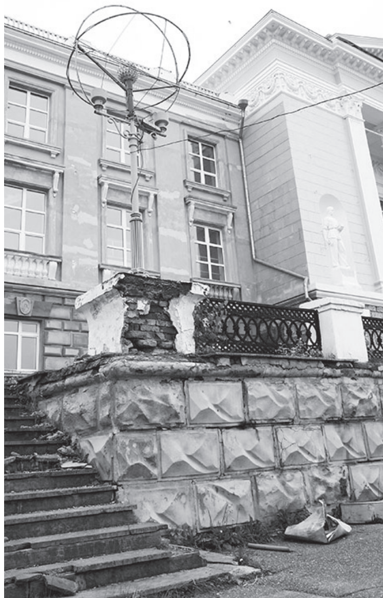
По информации подрядчика, в здании СКДЦ «Современник» разрушается фундамент и есть риск обрушения перекрытий
