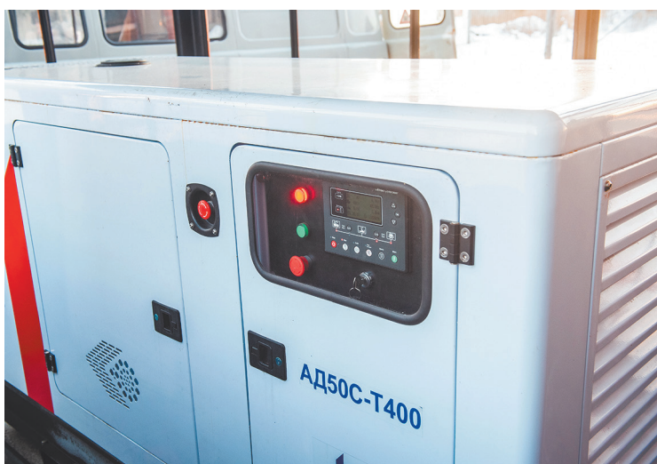
Эта аппаратура позволит котельной Чашавиты работать бесперебойно
