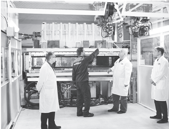
Проверка высоковольтного оборудования второго контура
