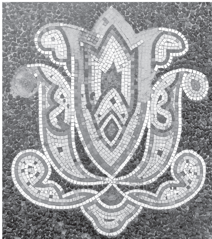
Разрушающийся «Каменный цветок» у входа в ДМШ г. Лесного
