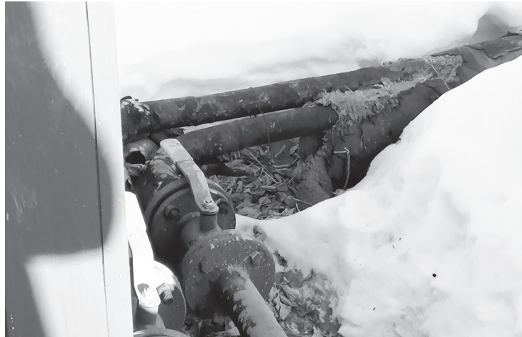
Уличные теплосети, Коммунистический проспект, 1. ФОТО АВТОРА
