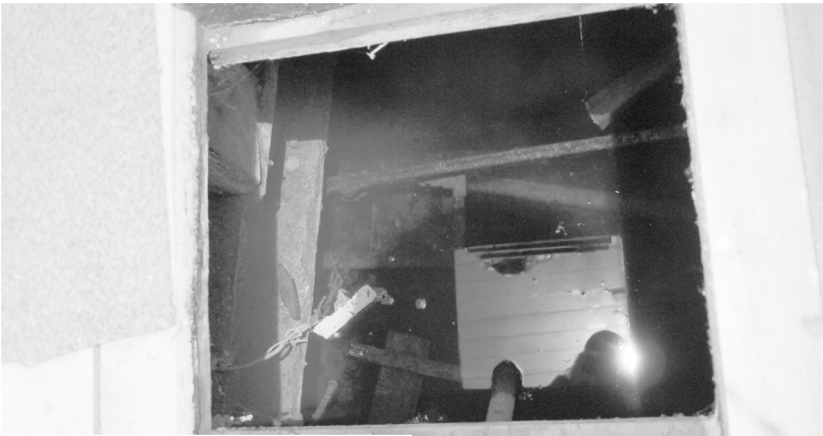
Подвал затопило горячей водой
